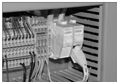
Anwendung: E-DAT modul REG 8(8) IP20 eingebaut im Maschinenverteiler.
