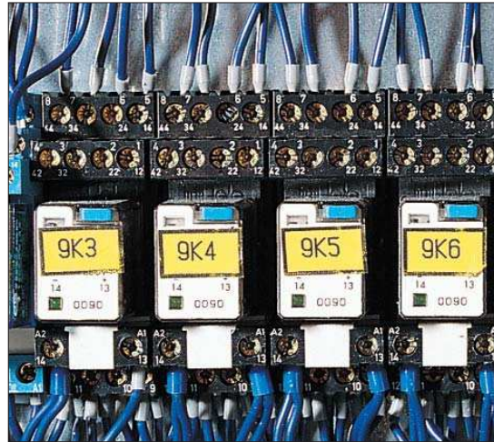
Sicherheit und Übersichtlichkeit im Schaltschrank: Helatag.
