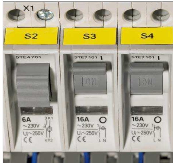
Helatag-Laser-Etiketten ermöglichen die einfache und schnelle Kennzeichnung von Schaltschränken.
