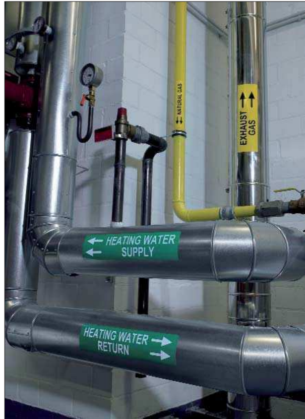
Eindeutig lesbare Beschriftung von Rohren und Leitungen.
